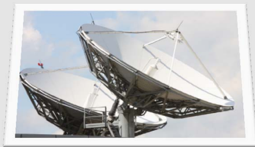
Tehnologii și sisteme de telecomunicații
