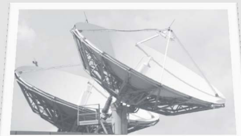
Tehnologii și sisteme de telecomunicații
